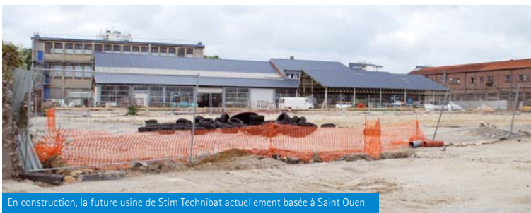
En construction, la future usine de Stim Technibat actuellement basée à Saint Ouen
